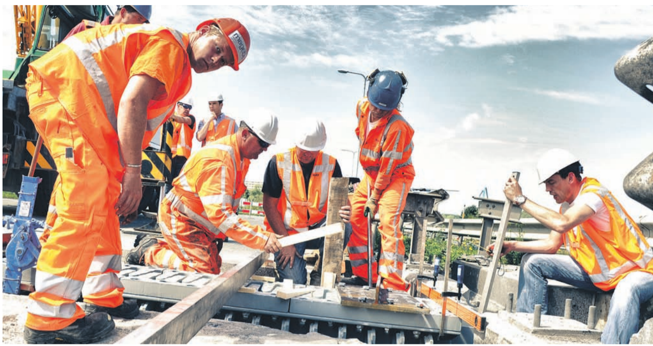
Unter der Anleitung von Fachleuten der Mageba SA wird ein Fahrbahnübergang des Unternehmens montiert.
